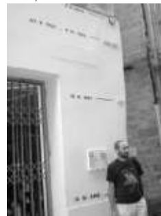
De nombreuses inondations marquées sur le mur.
